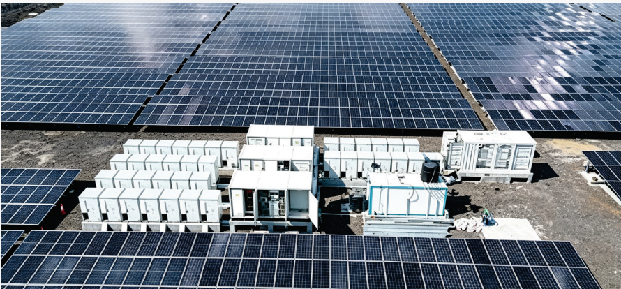
科摩罗光储柴一体化项目现场
